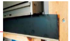
鋼板止水部材をサッシ面に押しつけながら胴縁に留め付けます
