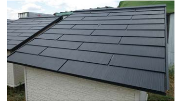
2016年8月測定データ 場所:滋賀県湖南市 屋根勾配:4寸 屋根面積:3.3m 2 断熱材なし 換気棟なし
